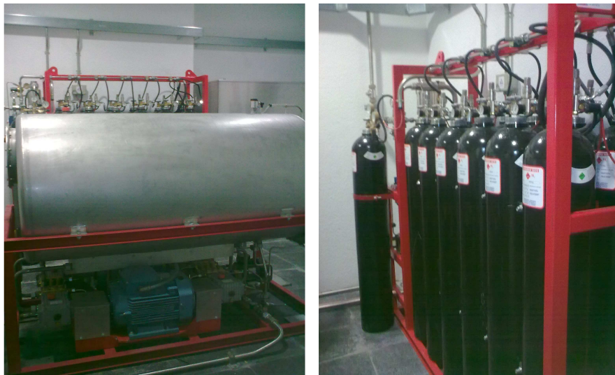
Imagen central de presión y bombeo sistema de agua nebulizada
