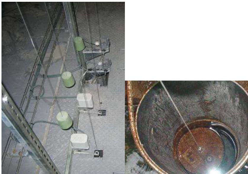
Imagen sistema de flotadores
