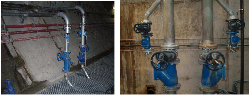
Imagen sistema de válvulas y tuberías
