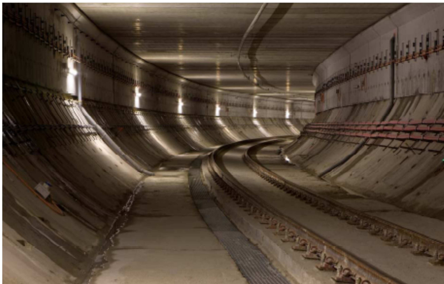
Imagen sistema alumbrado túnel
